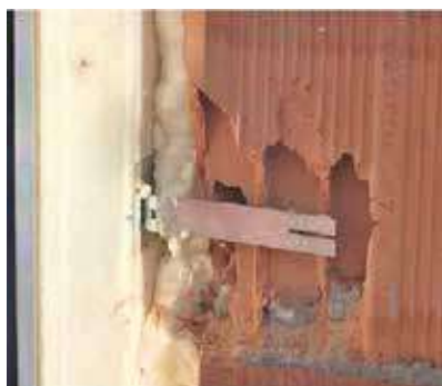
Foto 5. Apertura zanca su spaccatura laterizio
